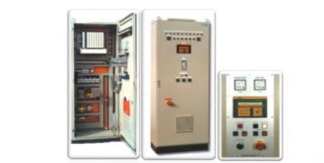
پروژه: اجراء و برنامه نویسی PLC S 7 - 400 و راه اندازی کمپرسور کارفرما: شرکت پیدک
